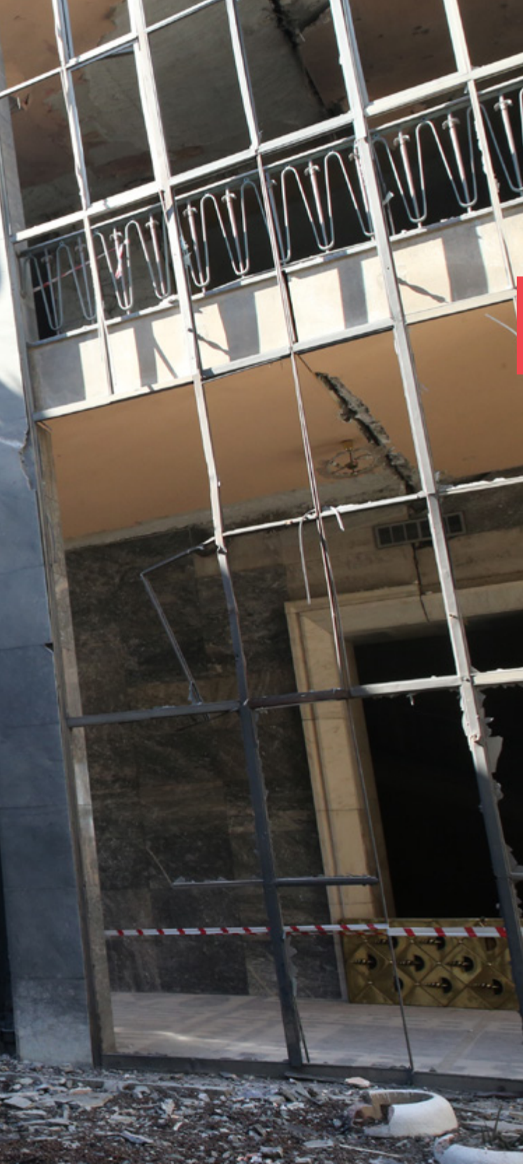
Teile des Parlaments (die Türkische Große Nationalversammlung) wurden durch Luftangriffe der Putschisten schwer beschädigt. Zu der Zeit fanden im Innern des Gebäudes Abgeordnetentreffen statt. AA/Aytaç Ünal.
